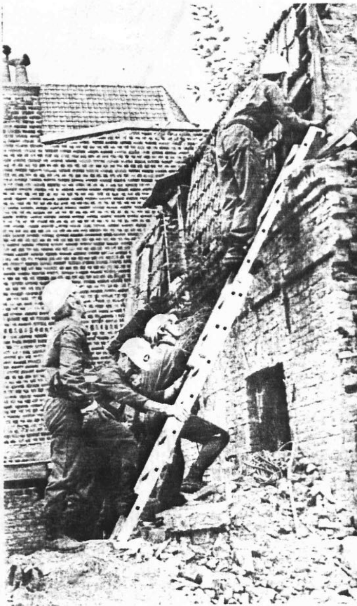
Après avoir exploré le rez-de-chaussée et le sous-sol, on essaie de s'introduire à l'étage.
